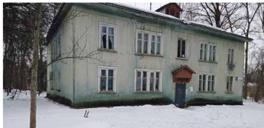
■ Аварийный дом на улице Глинки
