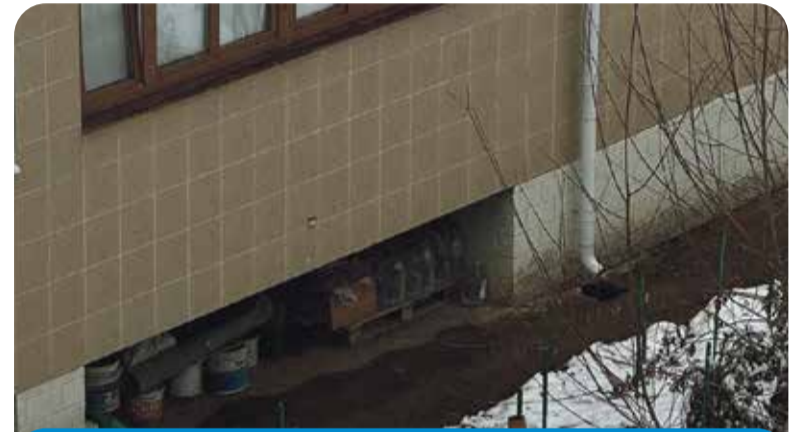
Целый склад всякой всячины под балконом. Это небезопасно!
