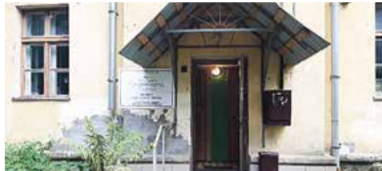
■ Фасад здания нуждается в ремонте
