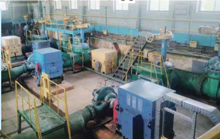
■ Насосная станция Вашутинского водозабора
