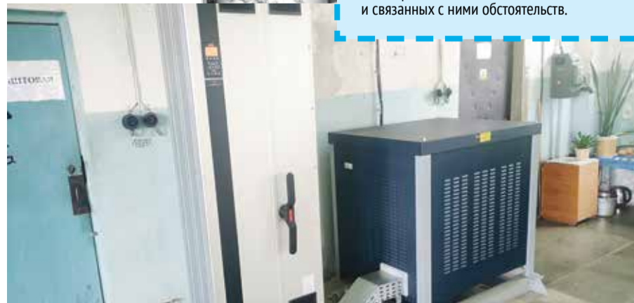
■ Шкаф управления и частотный преобразователь в насосной станции Вашутинского водозабора
