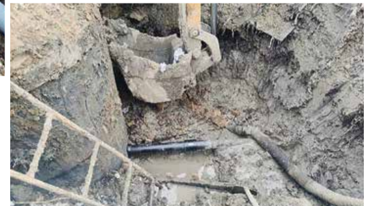
■ Устранение аварии на водопроводных сетях наукограда
