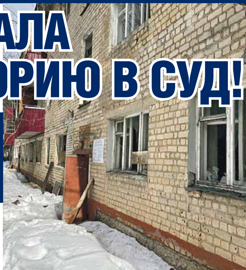
■ Выбитые стекла не мешают асоциальным элементам обитать в этом аварийном доме
