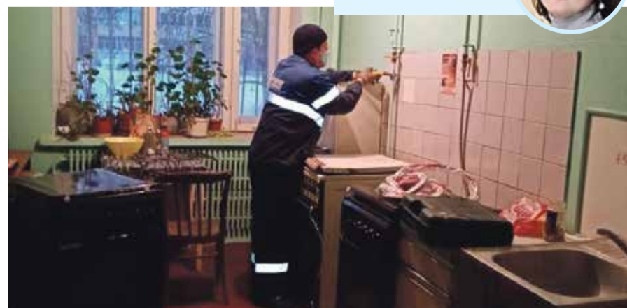
■ Газовое оборудование нужно регулярно проверять
