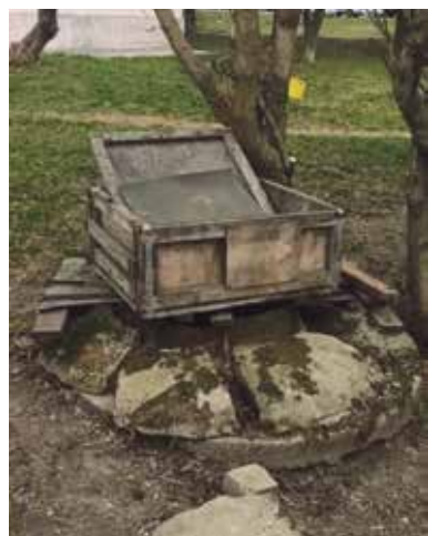
► Балабаново. Канализационный колодец на улице Дзержинского с ящиком «для сбора средств» на люк (18.04.2023).
