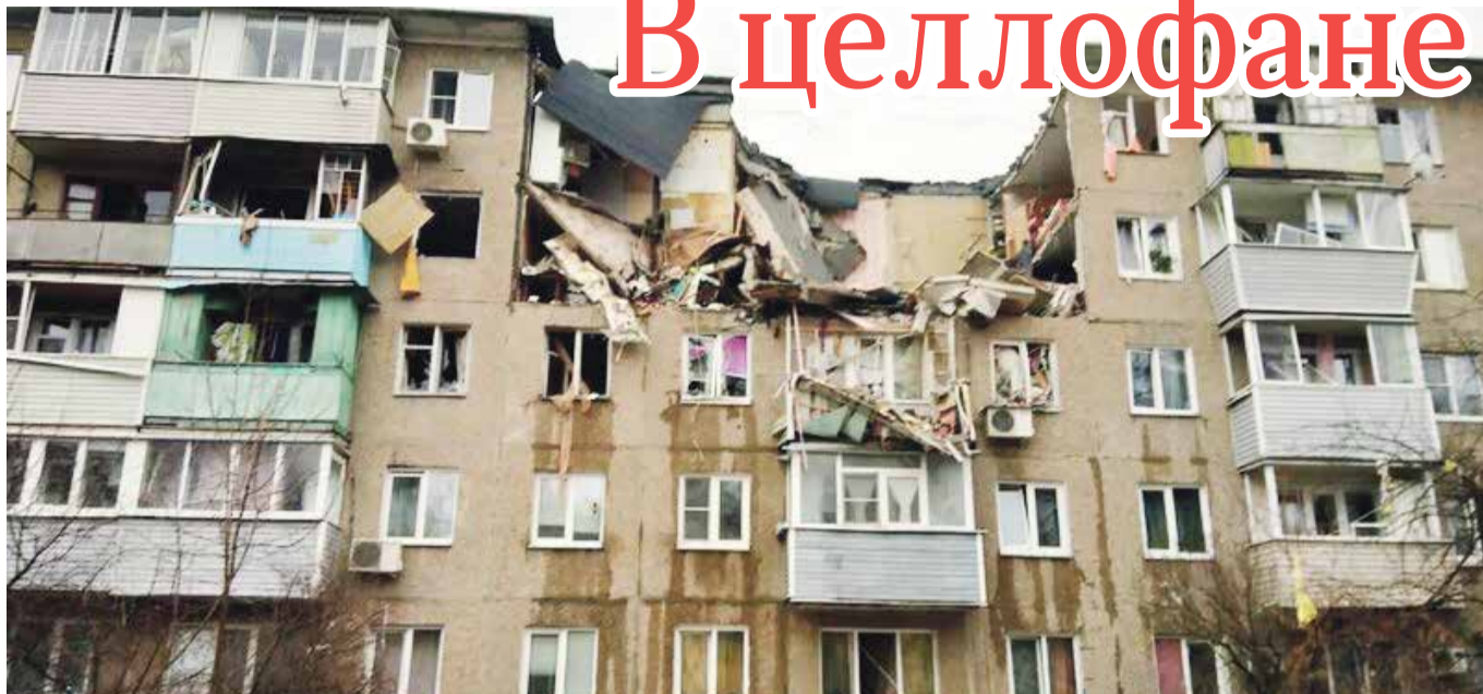
Последствия взрыва бытового газа в подмосковном Ступино
